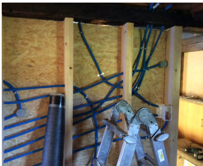
Einzug der Elektrizität
