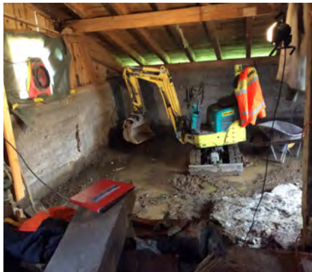
Wasserschaden bei Grabarbeiten
